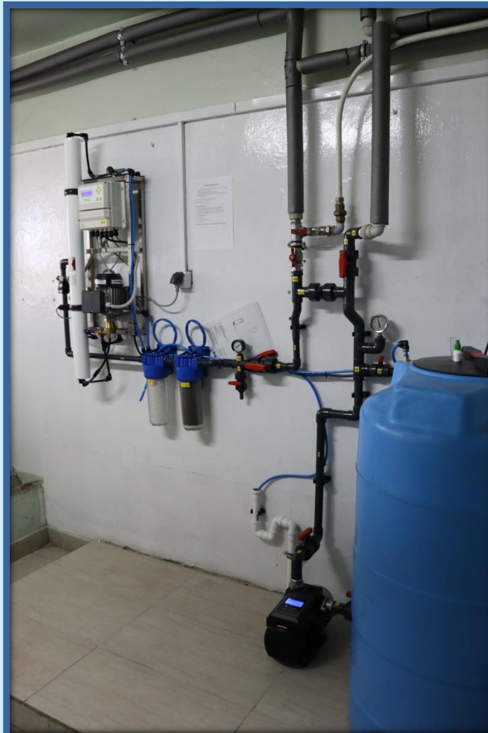
System uzdatniania wody
